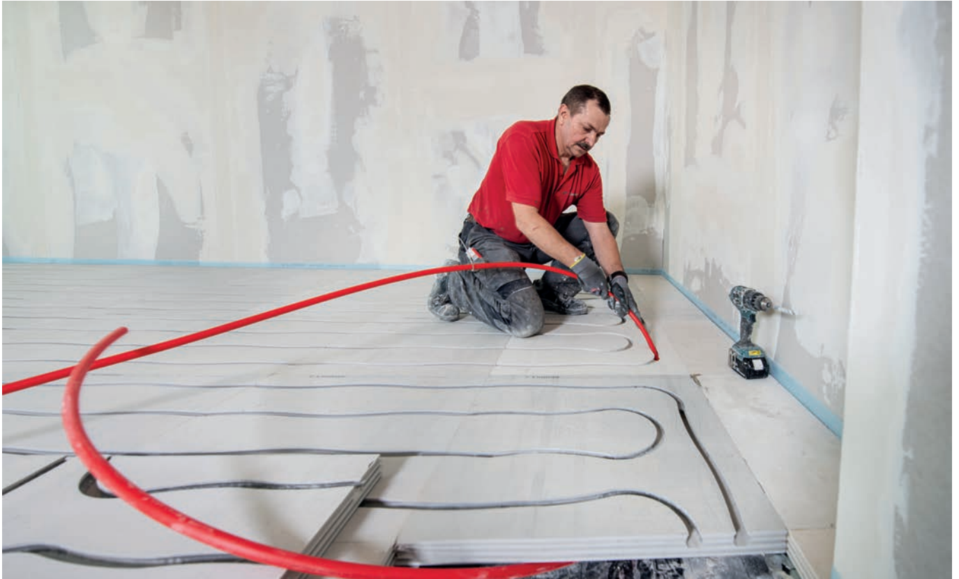
Anbindeleitung in Bodenhohlraum
