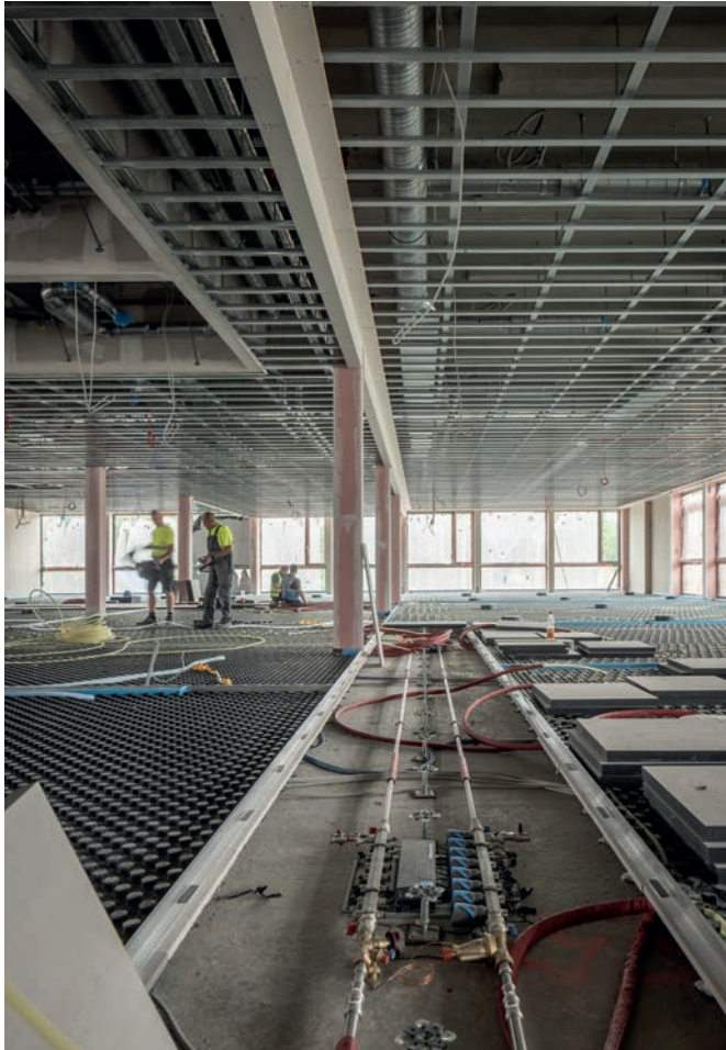
Installation in der Doppelbodentrasse mit Heizkreisverteiler
