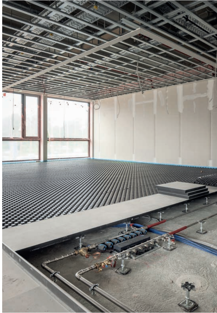
Installationen im Bodenhohlraum
